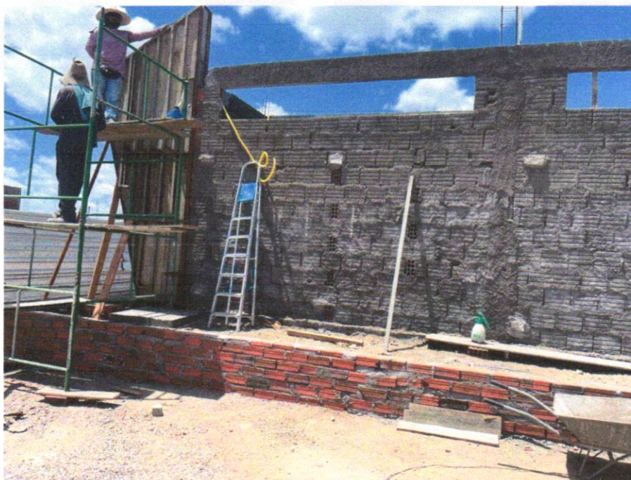
IMAGEM 12 – CHAPISCO APLICADO EM ALVENARIA (COM PRESENÇA DE VÃOS) E ESTRUTURAS DE CONCRETO DE FACHADA, COM COLHER DE PEDREIRO. ARGAMASSA TRAÇO 1:3 COM PREPARO EM BETONEIRA 400L. AF_06/2014
